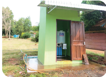
③ ノンケー中高校 井戸・水タンク・浄水器
